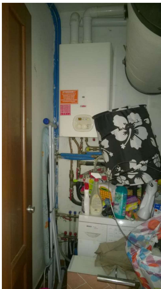
foto 22 – vista C.T. piano interrato
